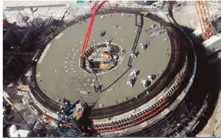
Figura 1. Construcción del reactor CAREM, un desarrollo tecnológico argentino que busca generar energía de forma segura. Fuente: Somos Jujuy
