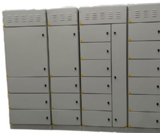
Gabinete modular con cubicados tipo CCM GM-C
