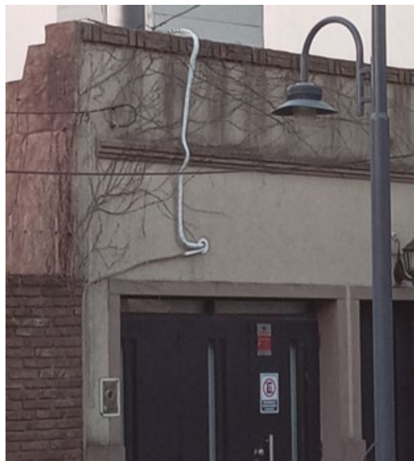
Foto 2: Antiestético y más que revuelto: en el mismo paquete, instalaciones eléctricas junto a tuberías de fluidos a presión, todo envuelto exteriormente por una vulnerable cinta blanca
