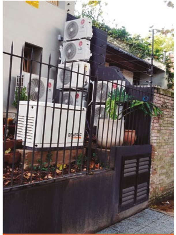
Foto 1: Amontonamiento en proximidad de pluviales y de una cerca (valla) eléctrica
